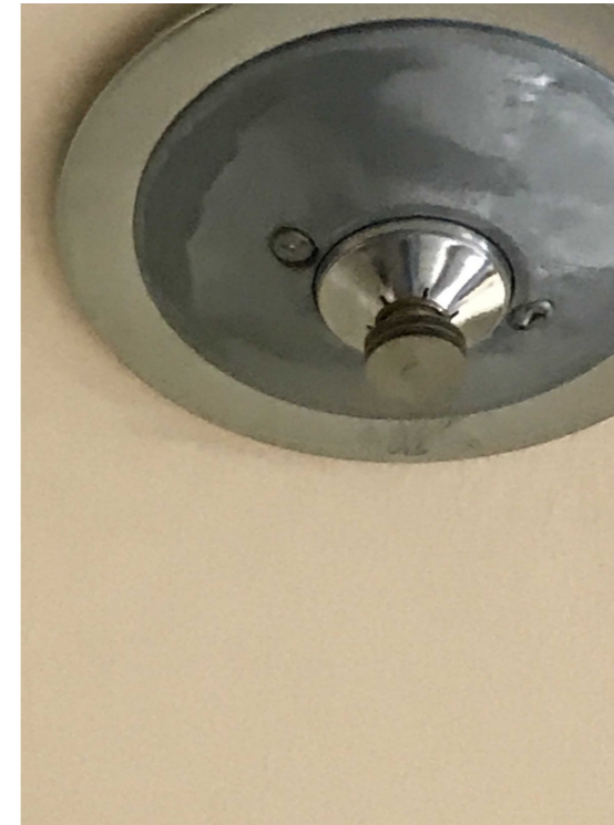
C8-240, 244, 237, 233 (Sprinkler) - Risk H
