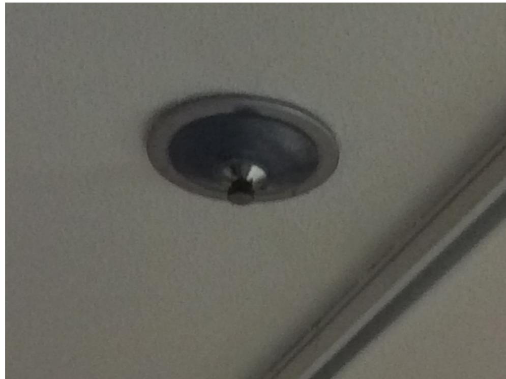
C8-205 (Sprinkler) - Risk H
