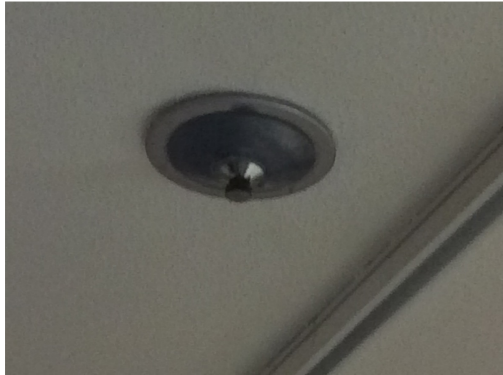
C7-146 (Sprinkler-like kind) - Risk H
