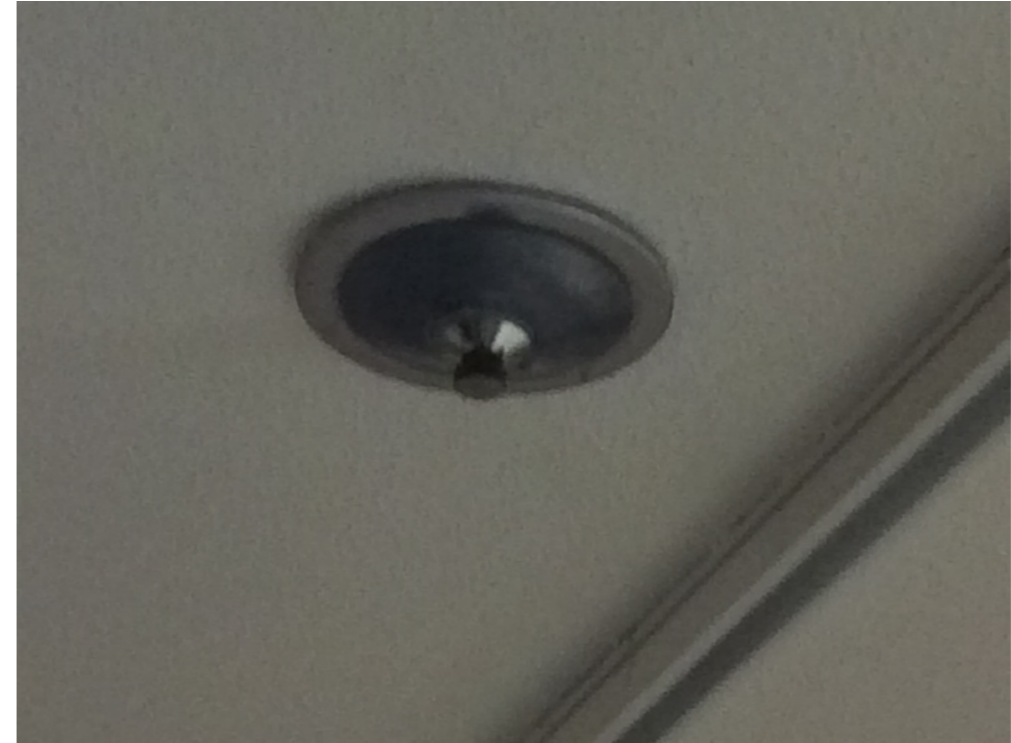
C9-353 (Sprinkler) -Risk M
