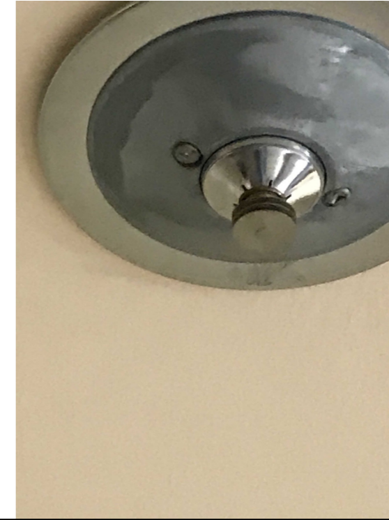
C8-208 (Sprinkler) - Risk H
