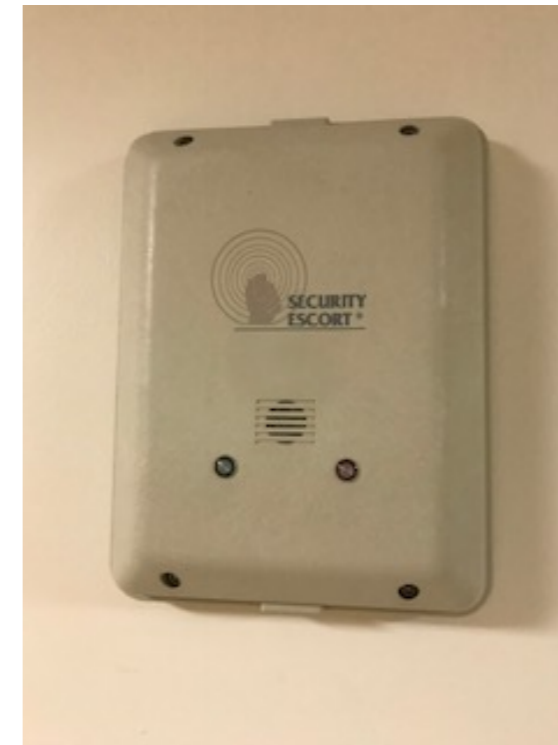
E1; E2; E3; E4; E5; E6; E7; E8 Corridor (Pendent alarm) - Risk H
