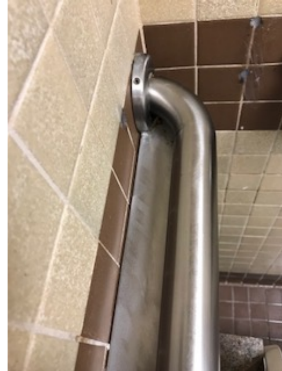
E1- 163, 152; E7- 146, 134, 131, 119; E5- 146, 120, 122 (Grab bars) - Risk H
