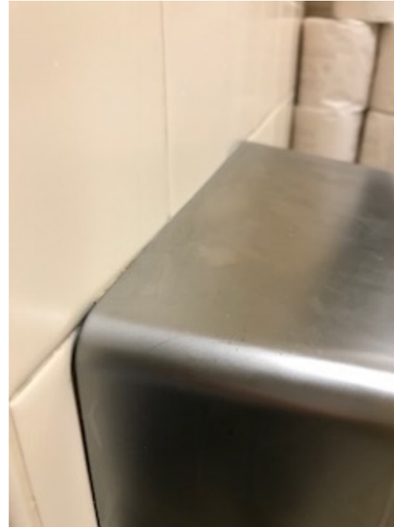
E1- Toilets; E7- 119; E5- 121, 122 (Hand dryer) - Risk H
