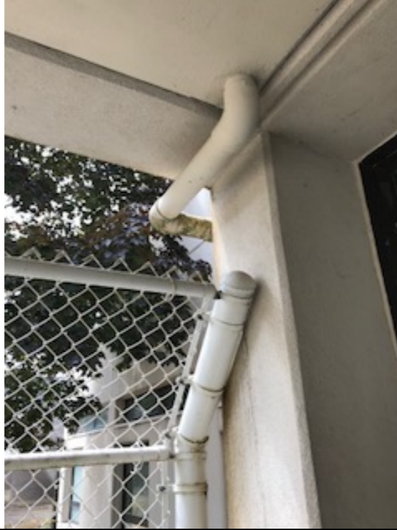
E1; E8; E6; E3 Patio (Drain pipes) - Risk H
