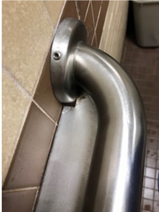
E1- 163, 152; E7- 146, 134, 131, 119; E5- 146, 120, 122 (Grab bars) - Risk H
